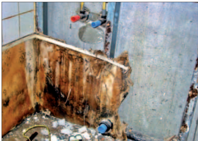
Wasserschaden durch „Heimwerkerinstallation“ in einem oberen Stockwerk - Arbeit für Maurer & Maler
