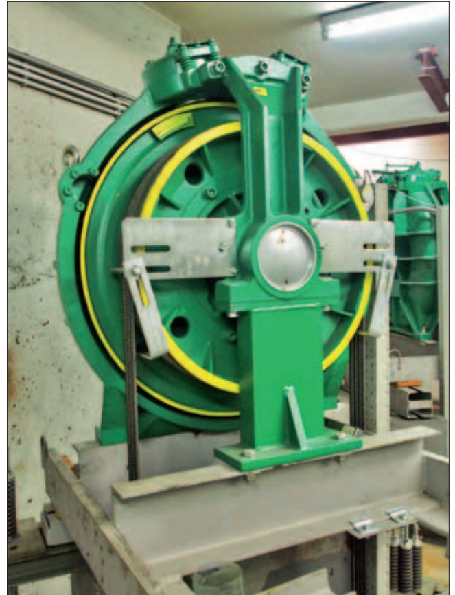
Neuer, energiesparender Aufzugsmotor im Block C
