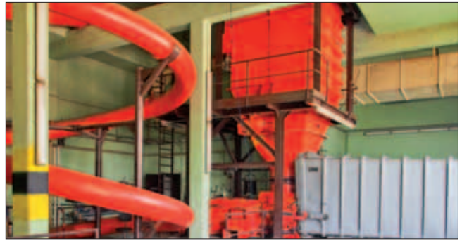
Müllzentrale mit Pressmüllcontainer
