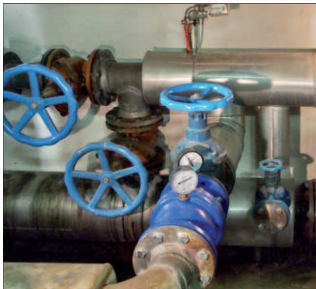
Übergabestelle vom Wiener Wasser an den Wohnpark (Block C)
