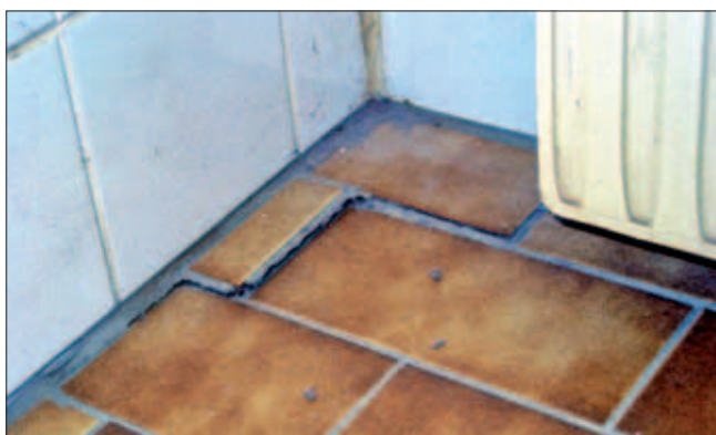
20 Jahre nach der Errichtung: Bewegungen des Baus verursachen kleine Risse
