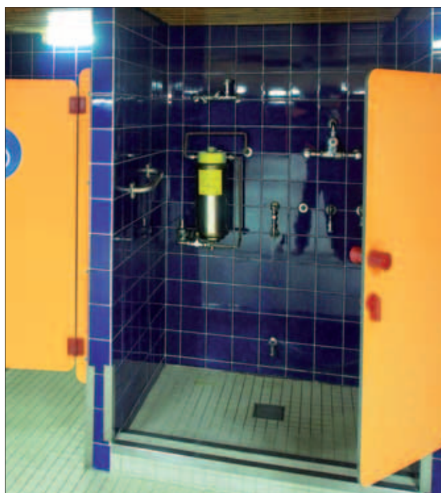
Brause in einem Hallenbad im C-Block
