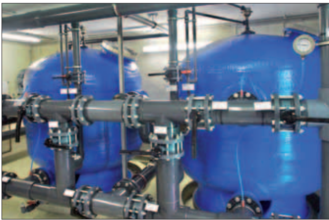
Dachbad: Moderne Wasserfilteranlage
